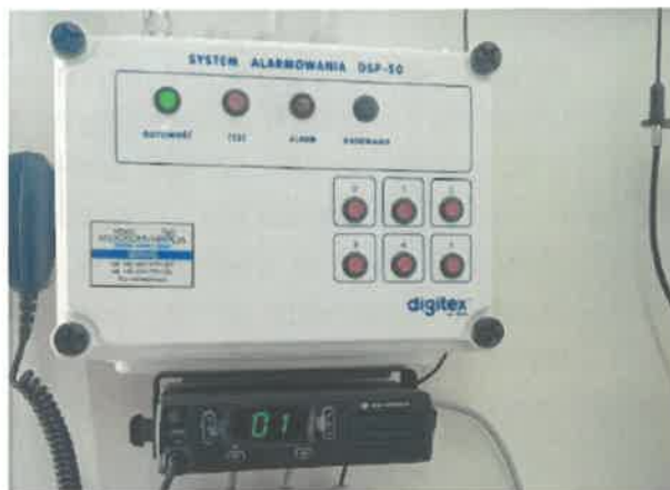
Nowy system alarmowania OSP w Wapnicy
