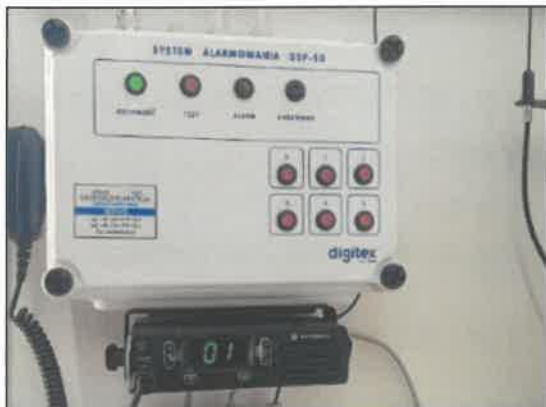
Nowy system alarmowania
