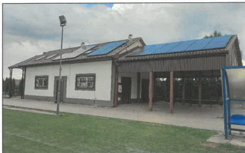
Instalacja fotowoltaiczna na budynku sportowców w Suchaniu
