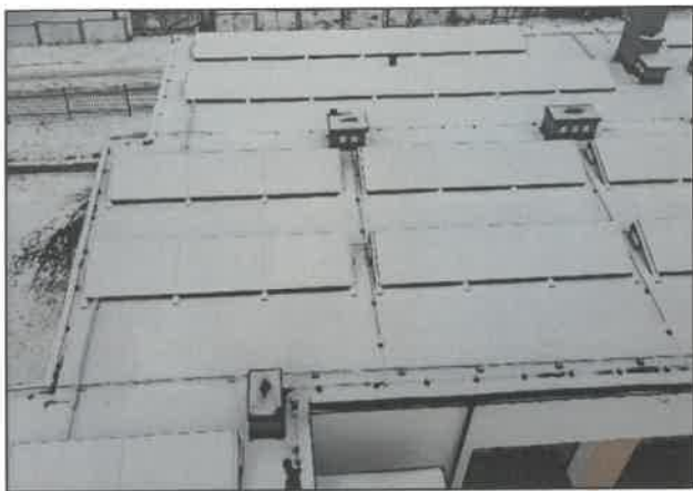
Instalacja fotowoltaiczna na budynku świetlicy w Wapnicy
