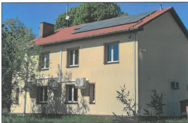
Instalacja fotowoltaiczna na budynku świetlicy w Nosowie
