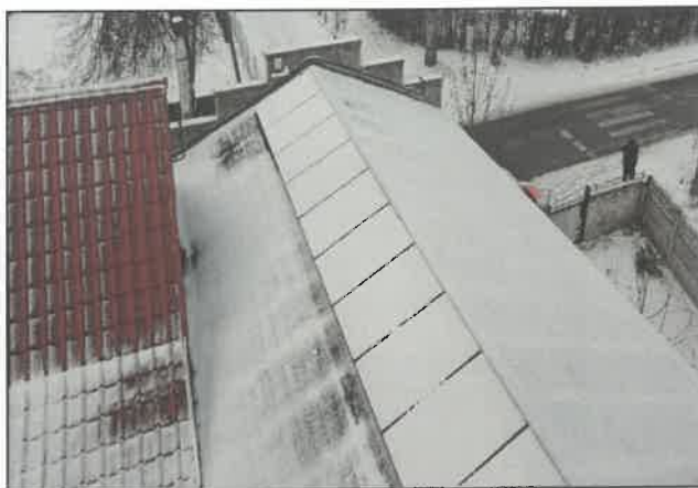
Instalacja fotowoltaiczna na budynku świetlicy w Tarnowie
