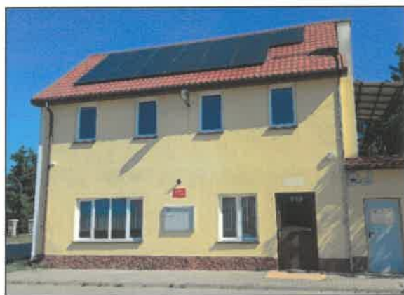
Instalacja fotowoltaiczna na budynku świetlicy w Żukowie
