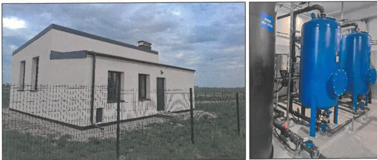
Stacja Uzdatniania Wody w Nosowie
