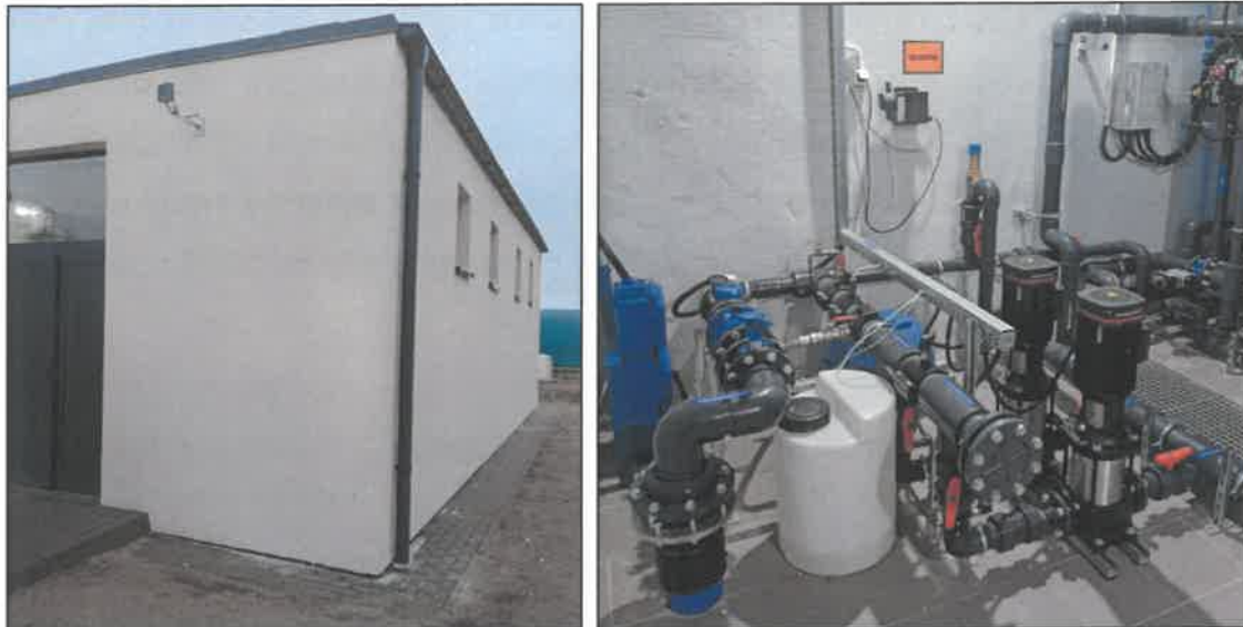
Stacja Uzdatniania Wody w Żukowie
