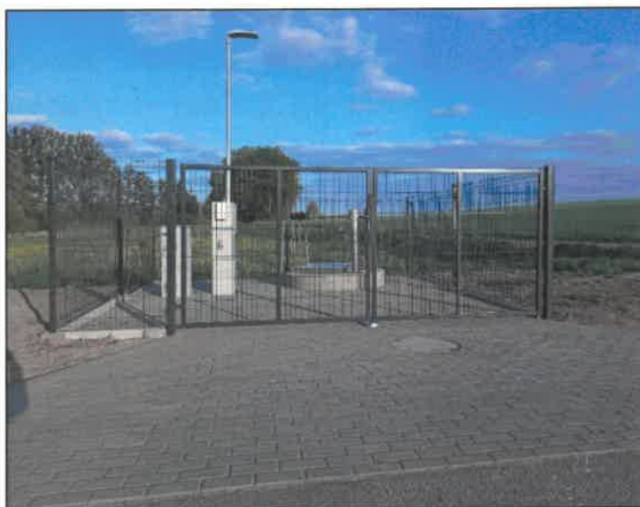
Przepompownia ścieków w Suchanówku
