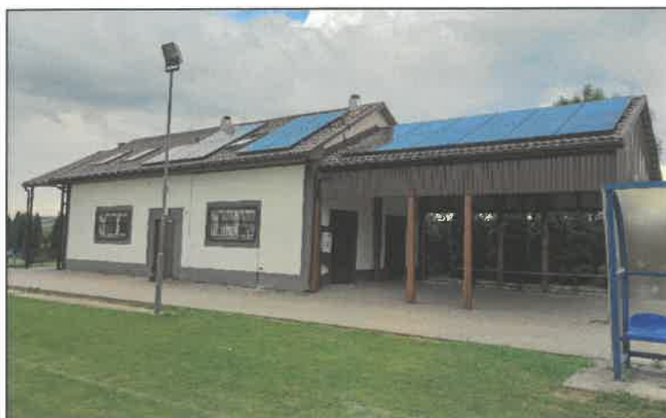
Instalacja fotowoltaiczna na budynku sportowców w Suchaniu
